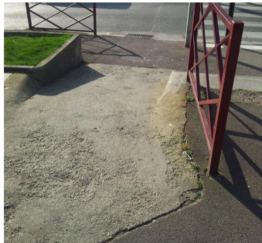
Revêtement en mauvais état et obstacles pour les malvoyants
