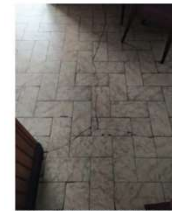
FISSURES SUR LE PLANCHER BAS DU RDC
