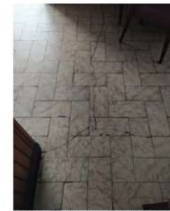
FISSURES SUR LE PLANCHER BAS DU ROC
