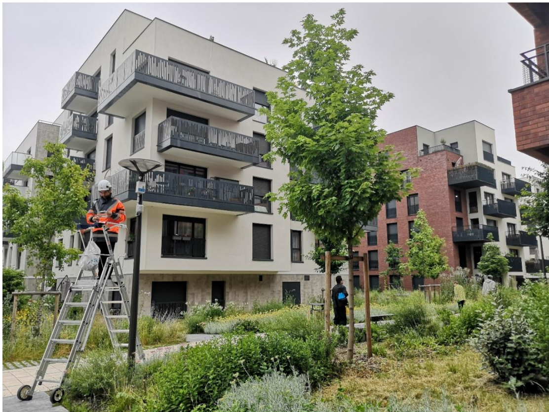
Figure 13 : installation d'un capteur de température Agralis au sein de l'îlot d'Engelhard
