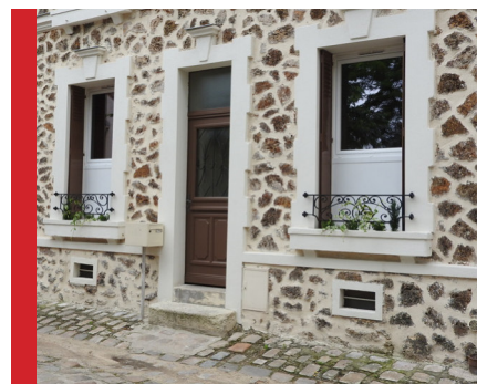
Mise en œuvre de joints trop clairs et trop larges qui du coup sont trop présents visuellement par rapport à la pierre meulière.
