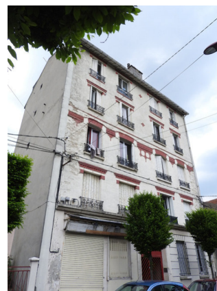
Immeuble dont les briques sont peintes en blanc et rouge et qui ne devraient pas l'être à l'origine. La restauration devra étudier ce point.
