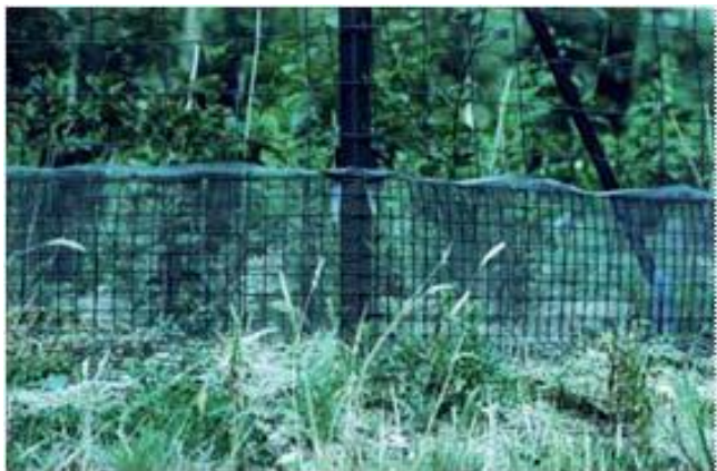
Autoroute A16 (SANEF), système de rabat en partie haute pour empêcher l'escalade de la petite faune
