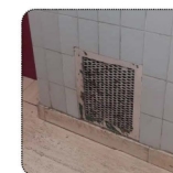
2 Grille en mauvais état
